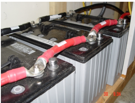
12 Volt DC Batteries
